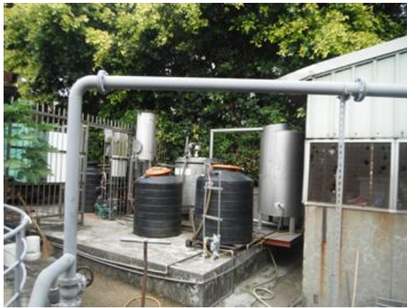
照片 1，模場設置於廢水處理廠現場
