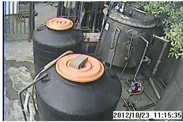
照片6，遠端監視模場設備運轉是否正常
